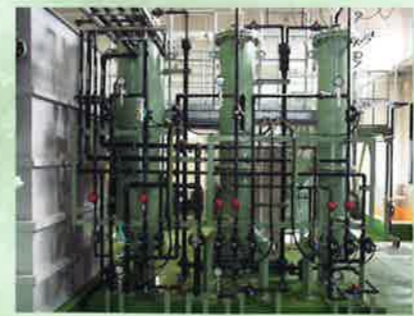
活性炭吸着塔
